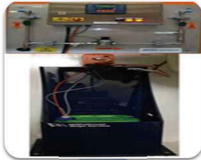
AQUAGUARD CW DOSING UNIT
